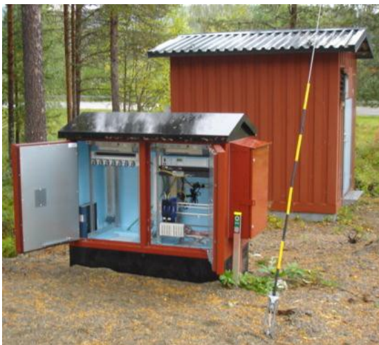
Exempel på föreningsnod i form av utomhusskåp framför teknikbod.
